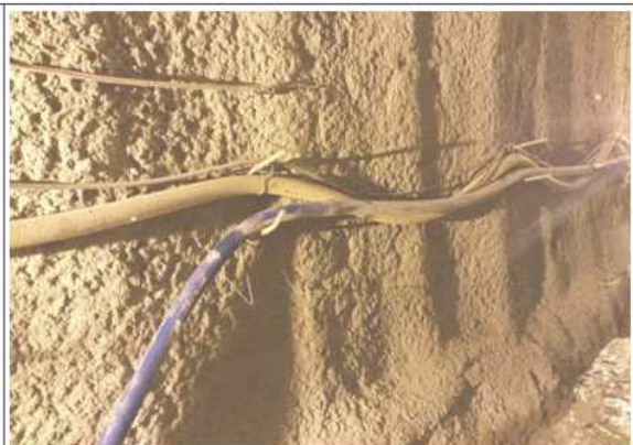
전선 벽에 부착 설치
